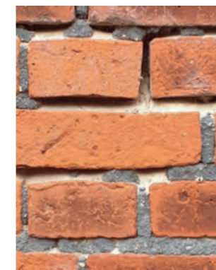
Eksempel på murværk omfugtet med cementmørtel, hvor fugen og mursten ikke kan arbejde sammen. Bagved cementfugen ligger den gamle kalkfuge.
